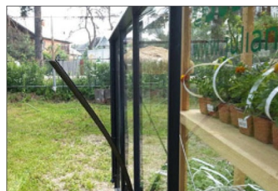
Накладки выскакивают из пазов
